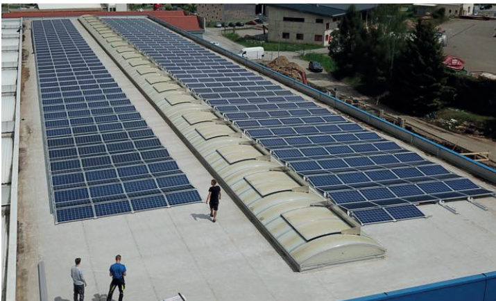
→ SCHEIFLING BEI MURAU, MURAUER STADTWERKE, 200 KWP
