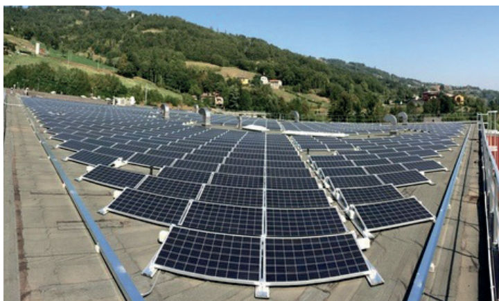
→ FANANO, MODENA, ITALIEN, 212 KWP
