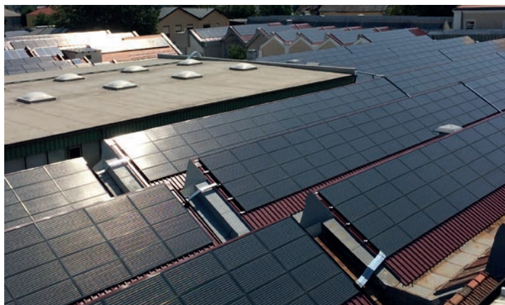
→ ENERGY3000 SOLAR MITARBEITERANLAGE, BAD VÖSLAU, 462 KWP
