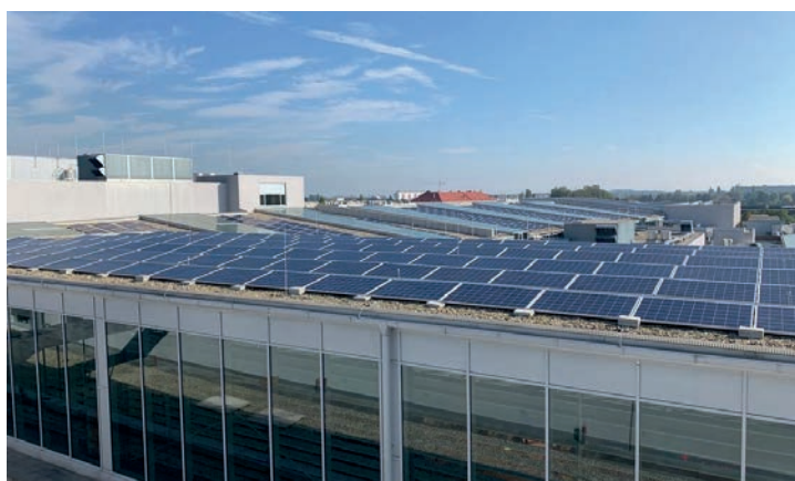
→ DONAUZENTRUM, WIEN, 1 MWP
