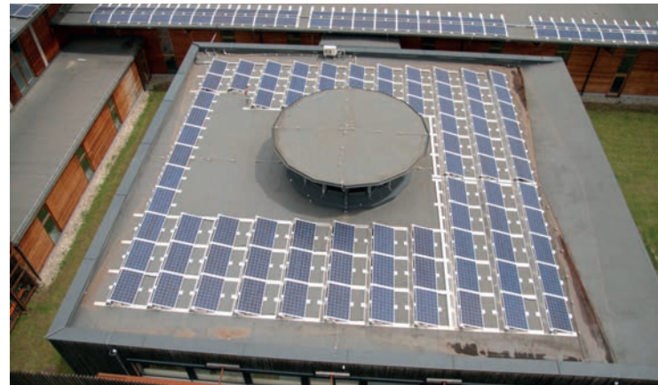
→ KÄRNTEN SOLAR, WEISSENSEER, 150 KWP
