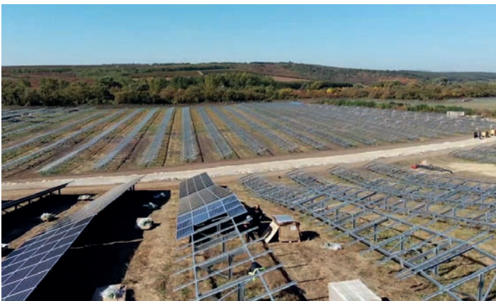
→ GREEN PLAN, UNTERKONSTRUKTION UND WECHSELRICHTER VON ENERGY3000 SOLAR, UNGARN, 22 MWP
