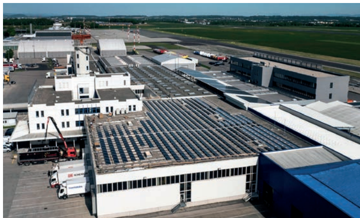
→ FLUGHAFEN LINZ, 400 KWP
