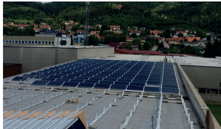
→ STADTWERKE JUDENBURG, HEIZWERK FOHNSDORF, 180 KWP
