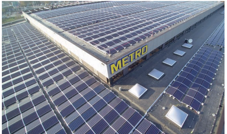
→ METRO, ST.PÖLTEN, 1 MWP
