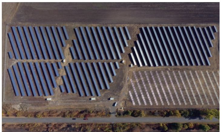
→ SOLARPARK NEWERGIES, UNGARN, 1,5 MWP
