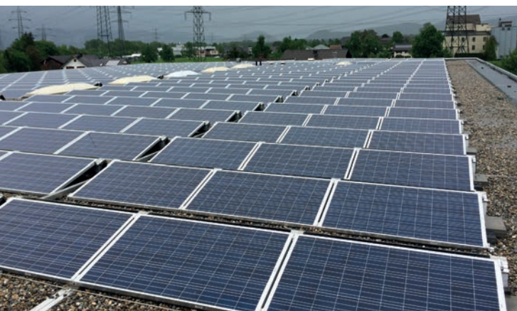
→ LEBENSHILFE RANKWEIL, 115 KWP
