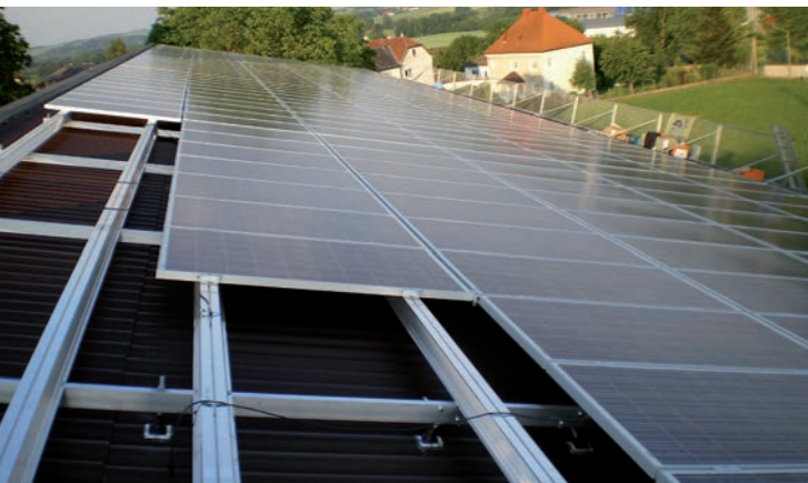
→ BÜRGERKRAFTWERK KREMSMÜNSTER, 100 KWP
