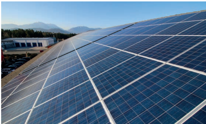
→ KÄRNTEN SOLAR, BAUSTOFF GRESSEL, POGGERSDORF, 200 KWP
